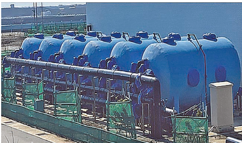
圖 1 馬公第二海水淡化廠第一期工程砂濾單元
