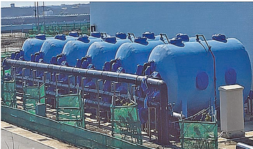
圖 1 馬公第二海水淡化廠第一期工程砂濾單元
