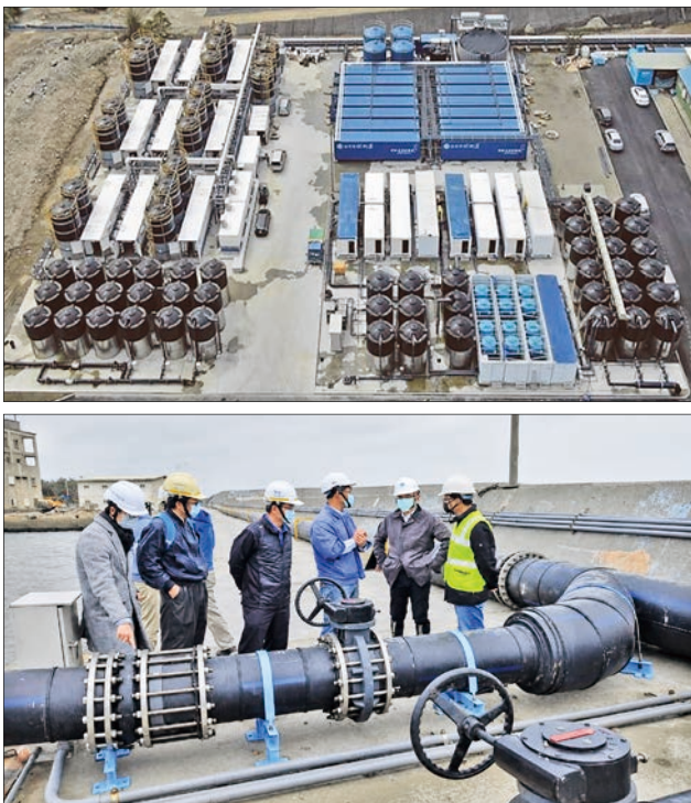
圖 4 新竹緊急海淡設施（上）及取水管（下）
