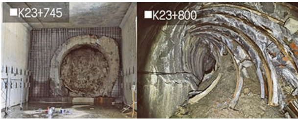
圖 15 集集線 K23 + 745、K23 + 845 既有隧道受損斷面
