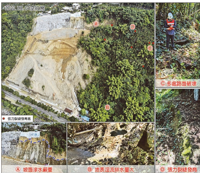
圖 11 發育（111 年）東側 K23 + 800 ~ K23 + 845 處多張力裂縫
