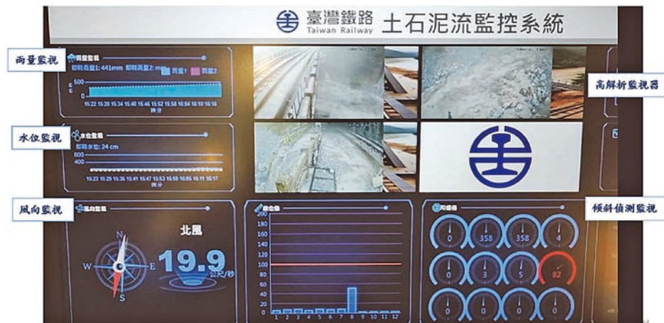
圖 5 花工段值班室土石流監控系統
