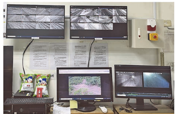
圖 4 0403 地震前花蓮工務段值班室監視告警設備
