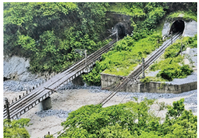
圖 2 小清水溪橋凱米颱風災後受損照片
