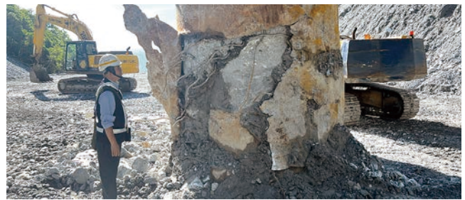
圖 4 東小清水溪橋橋墩遭受衝擊情況照片
