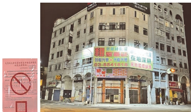
(a) 建築物地震發生後受損情形
