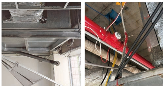
圖 16 A2 大樓四樓預冷空調箱冰水管斷裂（左），以及五樓預冷空調箱撞擊消防灑水頭（右）
