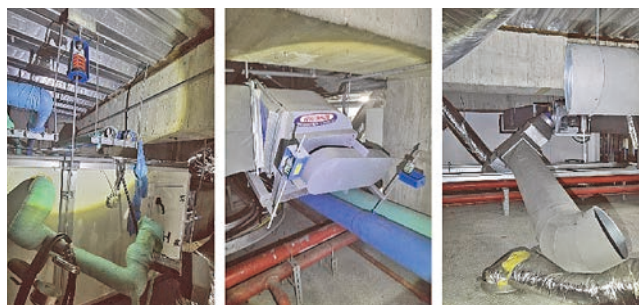
圖 17 空調箱之冰水管斷裂脫落（左），通風機之懸吊桿斷裂（中），通風機周邊風管破壞（右）
