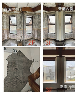
(d) 2、3 樓梯間伸縮縫處碰撞與牆體粉層剝落
