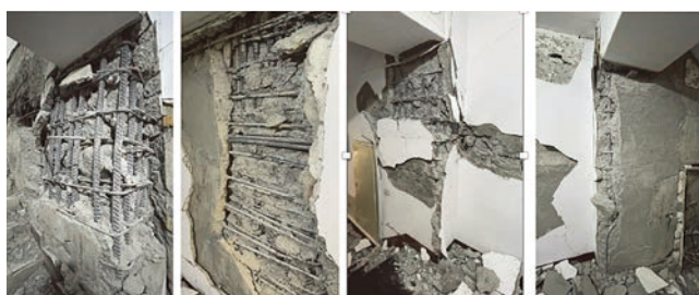
(b) 建築物地震發生後 A 棟一樓梯間之柱混凝土爆裂、鋼筋外露情形 圖 20 花蓮市中和街 209 號（靄邑京華）0403 地震發生前後情形
