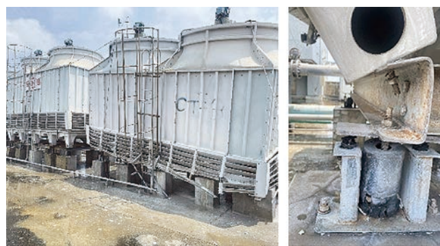
(a) FRP 冷卻水塔基座破壞歪斜
