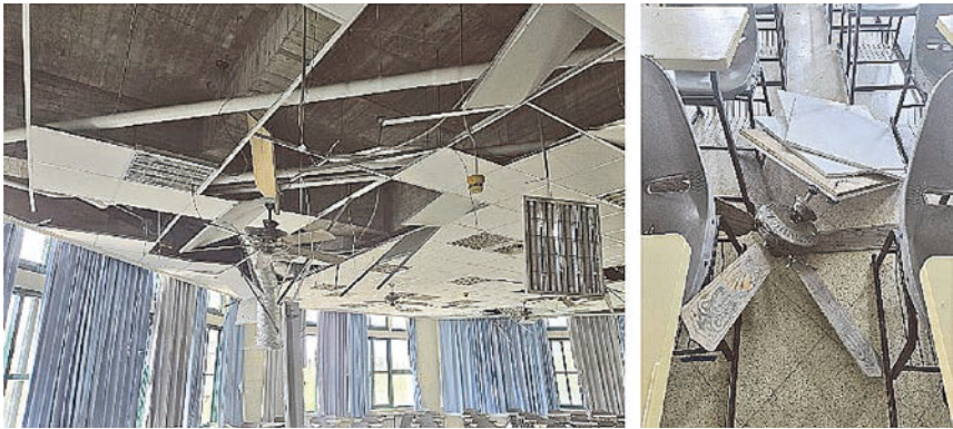
圖 2 D2 大樓三樓教室內天花板燈具及吊扇墜落
