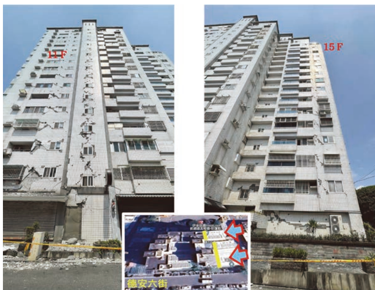
(c) 建築物地震發生後右側 RC 牆體開裂情形
