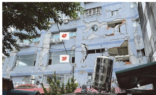
(b) 背面 RC 外牆開裂與磚造外牆倒塌
