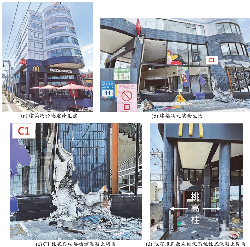
圖 16 吉安鄉中華路二段 11 號之 1 台雄商業大樓地震發生前後一樓破壞情形
