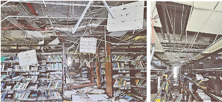
圖 1 DL 圖書館內五樓、六樓天花板大範圍崩落
