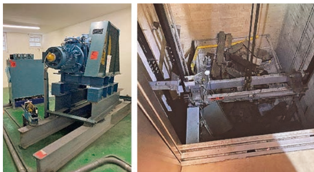
圖 12 電梯捲揚機位移（左圖）；另一座電梯平衡錘配重塊掉落（右圖）
