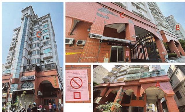
(a) 建築物地震發生後各棟損壞情形
