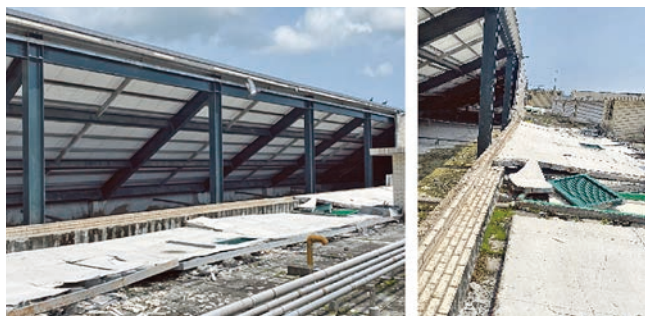
圖 8 輕質混凝土防風牆倒塌
