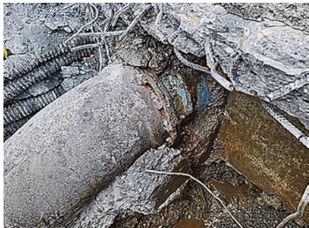
圖 8 2024 年花蓮外海地震中正橋兩端之過橋管脫接發生漏水 (台水公司提供)
