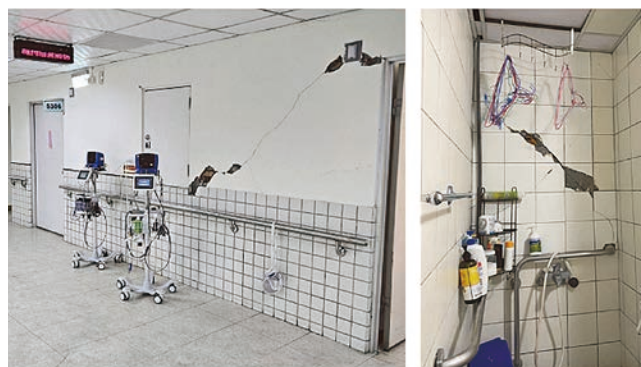
圖 6 病房磚牆兩面剪力破壞
