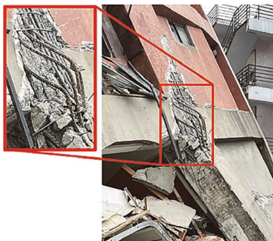
(c) 建築物地震發生後正視右後側三樓一梁柱接頭混凝土爆裂鋼筋外露情形
