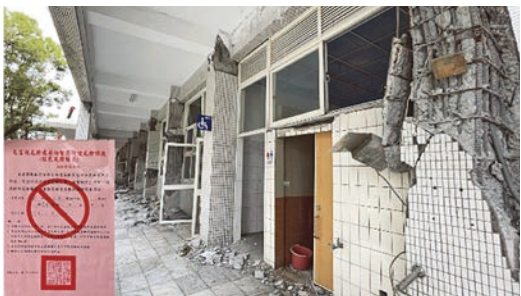
(a) 正面一樓受損情形
