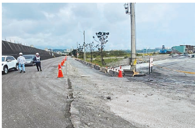
(a) 西防波堤道路鋪面下陷 (點位 L6)
