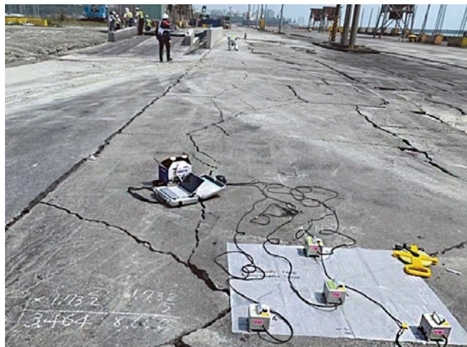
(b) 後線後方填土鋪面開裂 (點位 L9)
