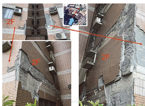
(b) 地震發生後背面內側牆體開裂
