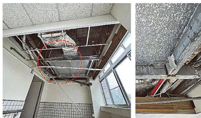
圖 5 A2 大樓 4 樓天花板與其他非結構物之互作用導致天花板崩塌
