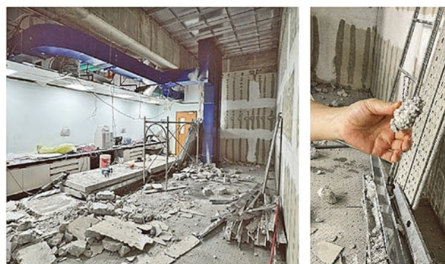
圖 7 輕質混凝土隔間牆傾倒，圖中正進行拆除
