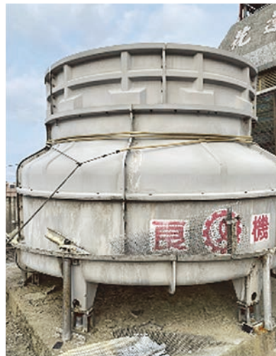
圖 10 A3 宿舍屋頂層之冷卻水塔之入風口導風裝置受損
