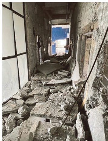
(c) 三樓樓梯間 RC 牆體混凝土破裂
