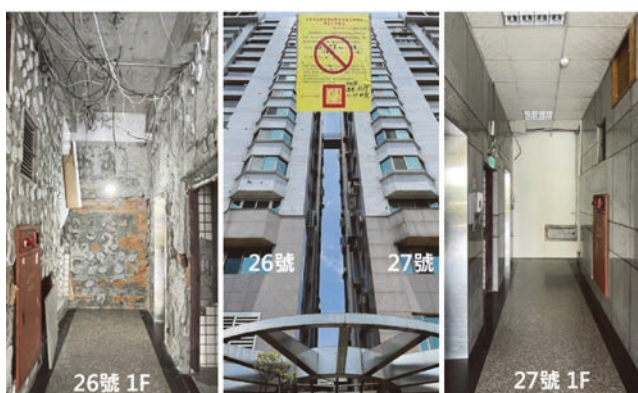
(a) 0423 餘震發生後一樓電梯間左棟受損嚴重，右棟損壞輕微，均被評判為黃單
