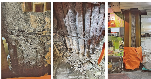
(b) 騎樓柱底混凝土爆裂，鋼筋外露情形
