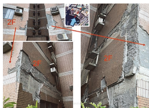
(b) 地震發生後背面內側牆體開裂
