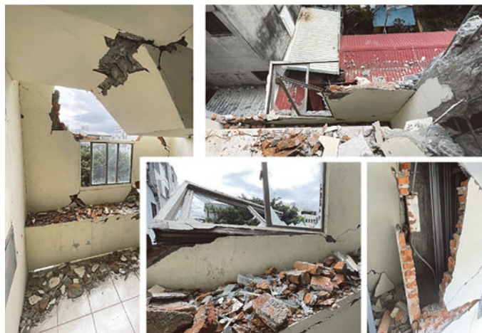
(d) 後側一至三之樓梯間破壞情形
