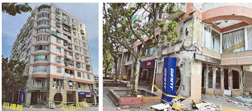
(a) 0403 主震發生後之破壞情形
