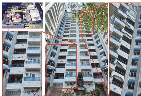
(a) 內側正面牆體開裂情形
