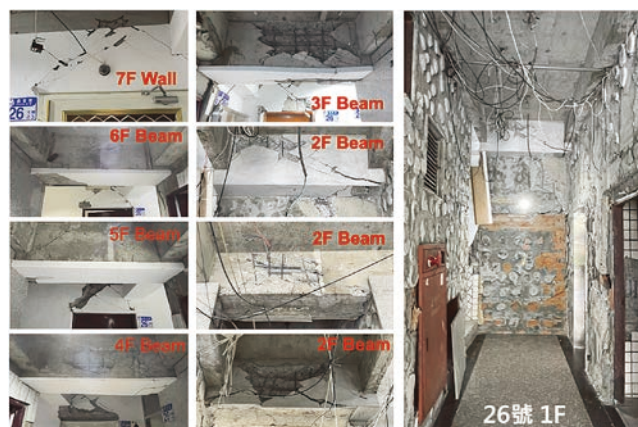
(b) 0423 餘震發生後左棟一樓電梯間，三至六樓梯間之情況
