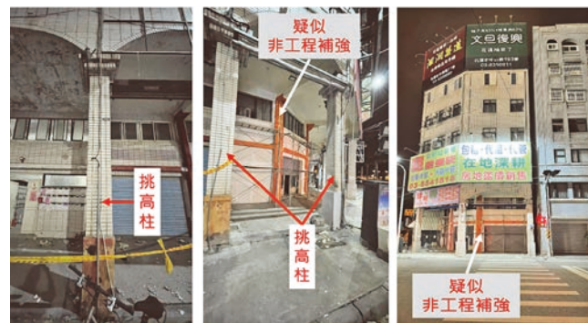
(b) 建築物騎樓挑高柱與前次地震（20180206 花蓮地震）損傷後之非工程補強
