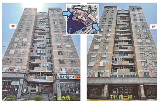
(c) 地震發生後兩側 RC 外牆混凝土開裂
