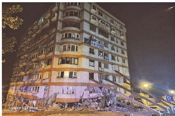
(d) 0423 餘震作用後當日一、二樓塌陷情形
