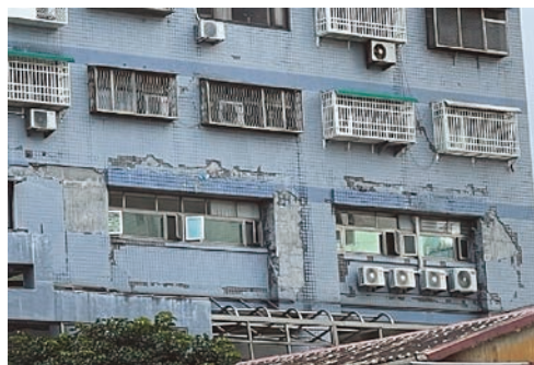
(a) 四樓正面右側外牆混凝土開裂情形
