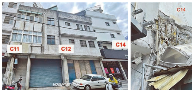
(b) 建築物地震發生後正面受損情形及 C14 之近照
