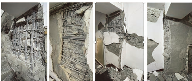
(b) 建築物地震發生後 A 棟一樓梯間之柱混凝土爆裂、鋼筋外露情形 圖 20 花蓮市中和街 209 號（觀邑京華）0403 地震發生前後情形
