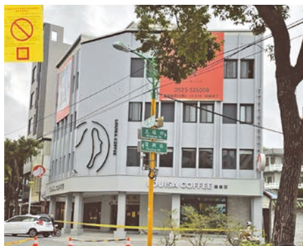
(a) 建築物於 0403 花蓮地震主震發生後正面視角情形
