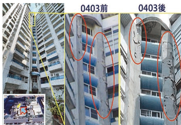
(b) 高樓層於地震發生前、後混凝土開裂比較
