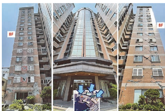
(a) 地震發生後梯間入口正面兩側牆體開裂情形
