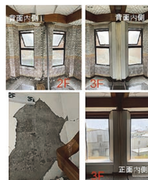
(d) 2、3 樓梯間伸縮縫處碰撞與牆體粉刷新剝落
