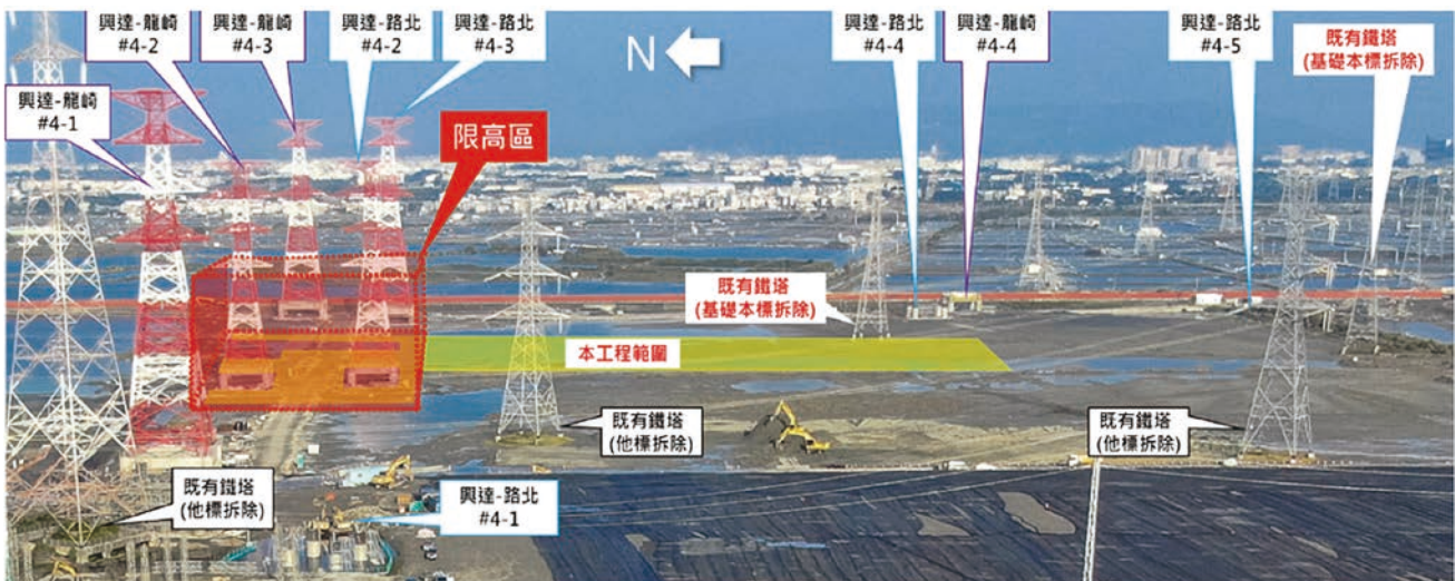
圖 5 工區佈滿台既有 345 kV 特高壓電塔，施工易發生感電危害
