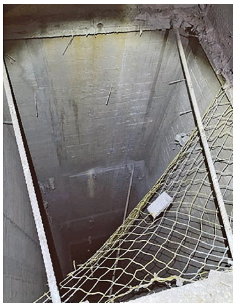
圖 2 電梯井井工作平台拆除作業時墜落 [5]
