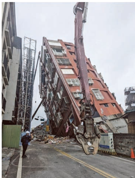
圖 2 花蓮天王星大樓倒塌（資料來源：施忠賢理事長提供）
