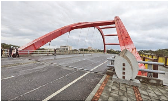
美崙溪橋震後東北側外觀
