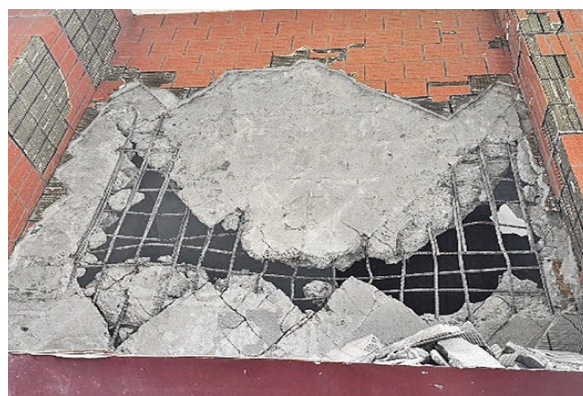
圖 43 鏡邑京華梯間牆 X 型裂縫 / 剝落
