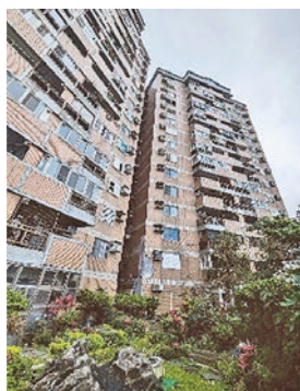
山海觀大樓震後西側外觀
