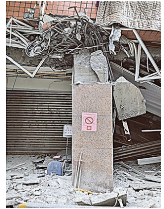
圖 109 統帥花蓮大樓 1F 騎樓柱嚴重破壞
