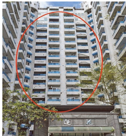
圖 52 蓮花大樓女兒牆水平+斜向裂縫達 15F (西南側)
