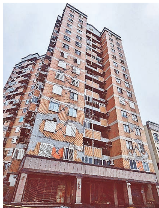
圖 45 山海觀大樓西南側外牆受損至 9F
