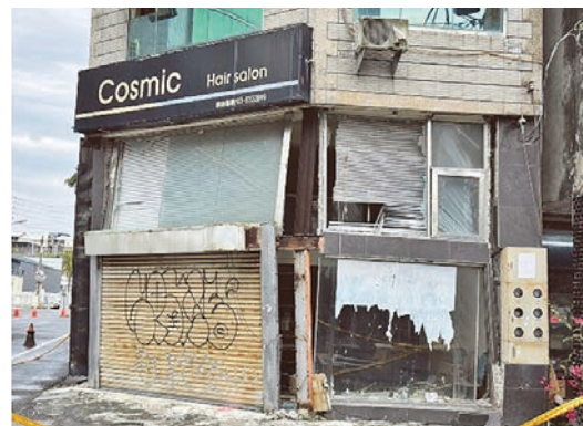
圖 34 博愛街 52 號民宅騎樓增建鋼柱傾斜
