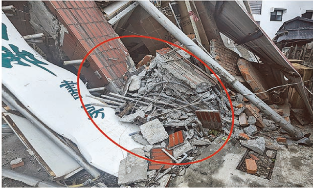
圖 13 天王星大樓柱端部嚴重破壞、主筋彎折（北側拍攝）
