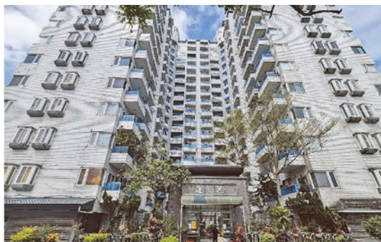
蓮花大樓震後西南側外觀
