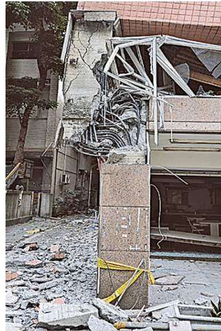
圖 104 0423 統帥花蓮大樓夾層粉碎
