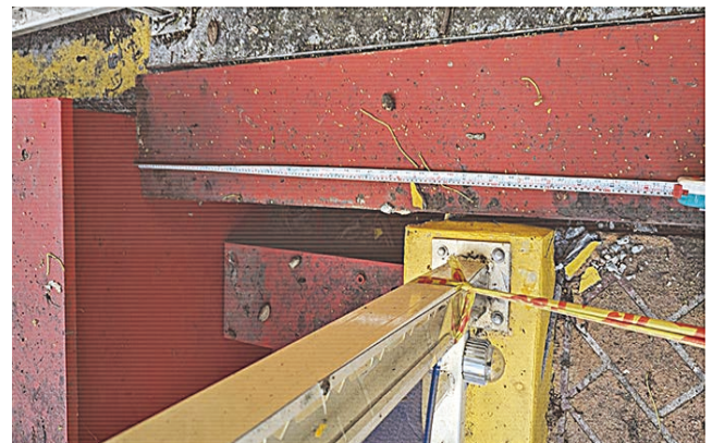
圖 93 菁華橋北側橋端東西向錯位約 86 cm
