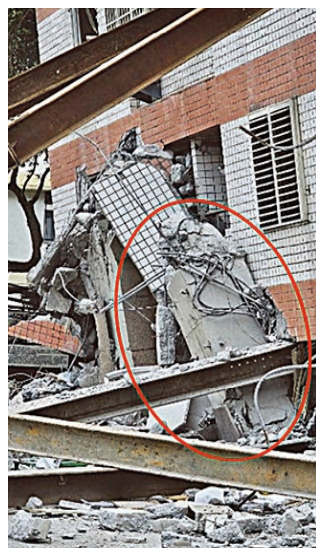
圖 107 0423 統帥花蓮大樓 1F 騎樓柱嚴重破壞 (攝影：林家宏)
