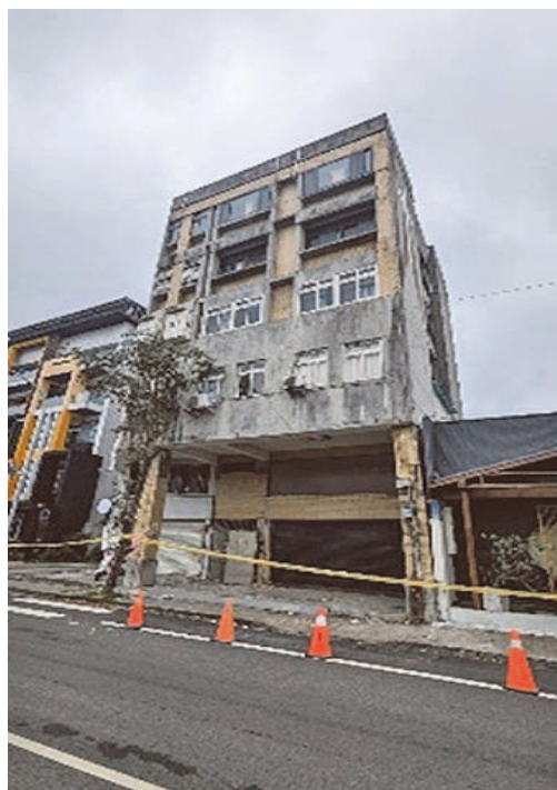
圖 27 北濱街 6 號民宅外觀已傾斜
