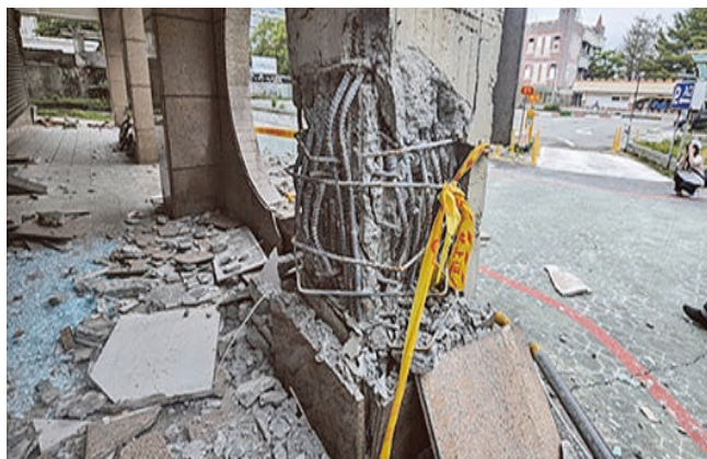
圖 21 統帥花蓮大樓轉角柱損壞嚴重
