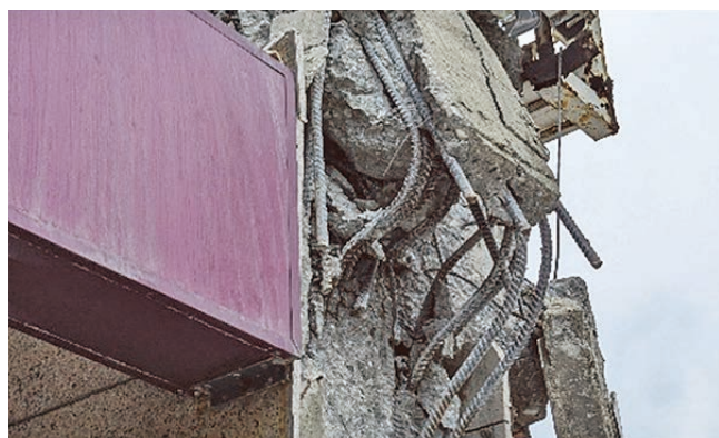
圖 23 統帥花蓮大樓損壞嚴重
