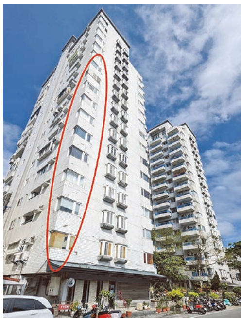
圖 51 蓮花大樓窗台牆斜向裂縫達 11F (西側)
