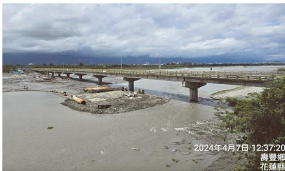
花蓮大橋震後南側外觀
