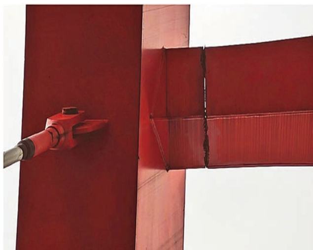
圖 77 美崙溪橋西南側梁構件鉚道斷裂（見光）
