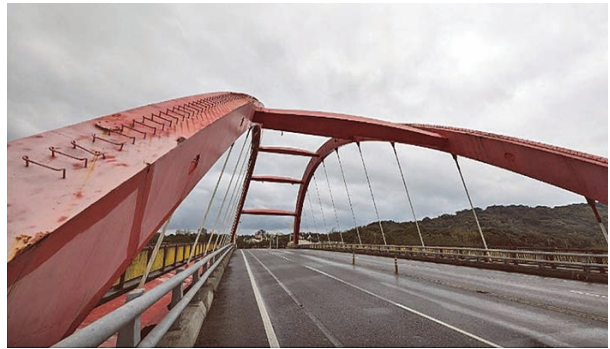
美崙溪橋震後西側外觀
