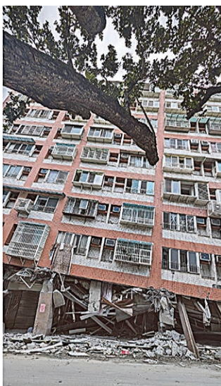
圖 106 統帥花蓮大樓 1F 騎樓柱嚴重破壞
