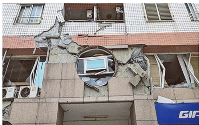
圖 22 統帥花蓮大樓夾層柱破壞
