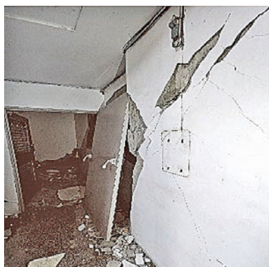
圖 24 統帥花蓮大樓梯間牆破壞
