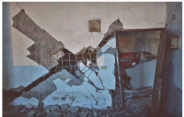
圖 61 華爾街大樓 3F RC 牆損壞嚴重
