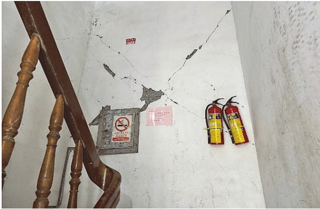
圖 28 北濱街 6 號梯間牆剪力破壞
