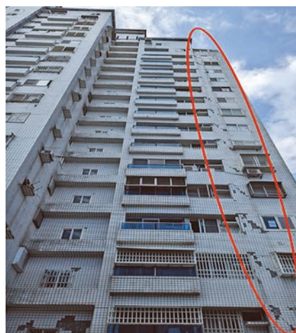
圖 53 蓮花大樓窗間牆斜向裂縫達 15F (東側)
