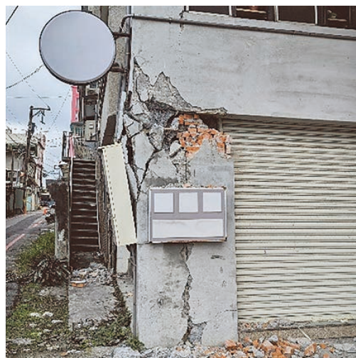
圖 26 北濱街 6 號民宅夾層柱剪力破壞
