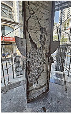
圖 85 0423 藍天麗池飯店柱體剪力破壞
