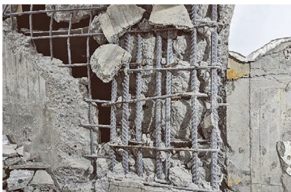
圖 40 鏡邑京華柱核心混凝土碎裂、主筋變形
