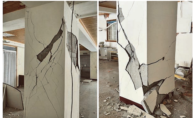
圖 19 統帥花蓮大樓柱體扭轉剪力破壞
