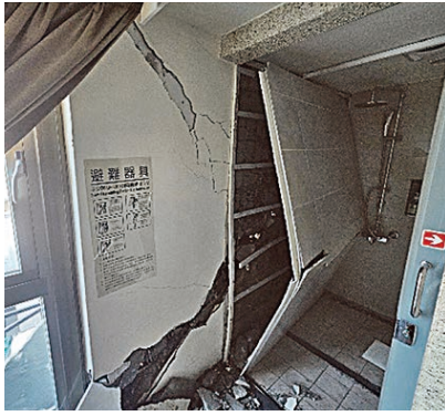
圖 86 0423 藍天麗池飯店牆體剪力破壞
