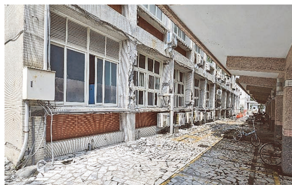
花蓮女中綜合大樓震後東側外觀
