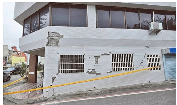
圖 36 更生日報底層牆面窗斜向裂縫
