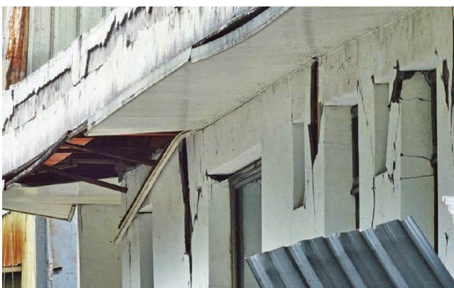
圖 90 0423 吉安鄉自強路廢棄工廠倒塌
