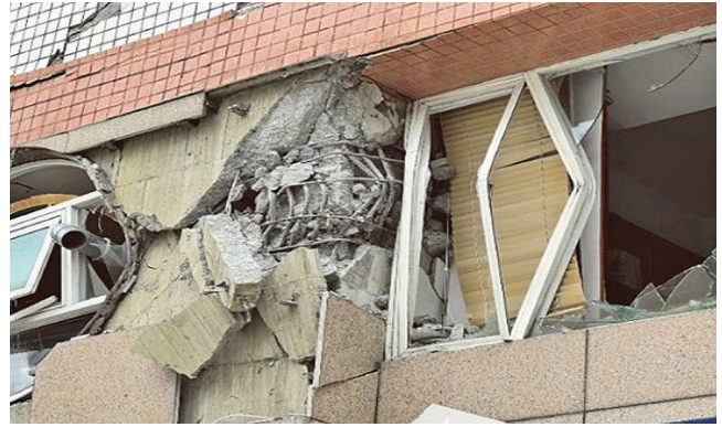
圖 17 統帥花蓮大樓短柱剪力破壞、主筋挫屈
