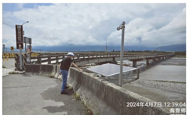
花蓮大橋震後東側外觀
