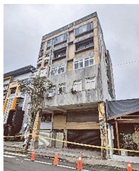
北濱街 6 號民宅震後西側外觀
