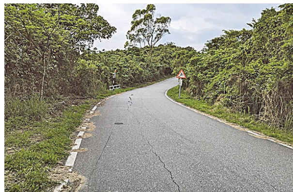
圖 99 0423 東山安樂園鄰近柏油路面裂縫
