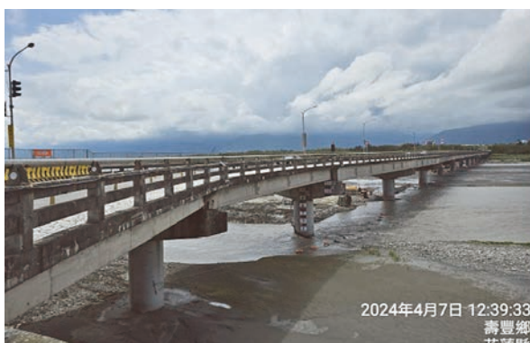
花蓮大橋震後東側外觀
