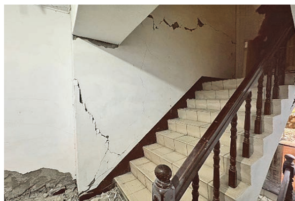
圖 42 鏡邑京華梯間牆斜向裂縫、樓梯版周圍裂縫
