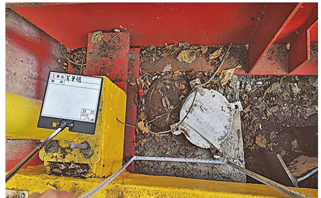
圖 94 菁華橋北側支承錯動脫落
