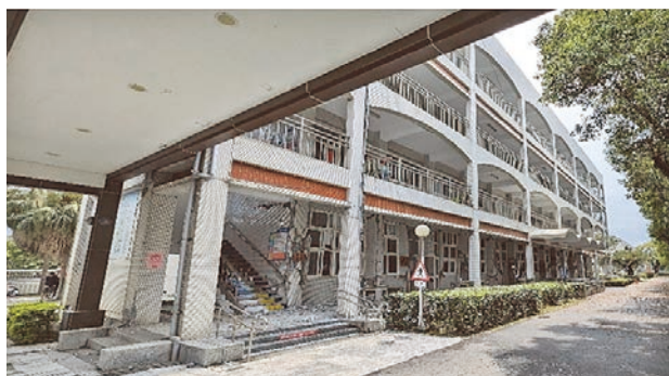
花蓮女中綜合大樓震後西側外觀
