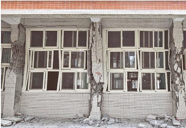
圖 69 花蓮女中窗台牆短柱破壞
