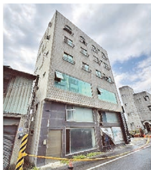
博愛街 52 號民宅震後東北側外觀
