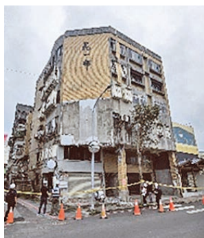
北濱街 6 號民宅震後北側外觀
