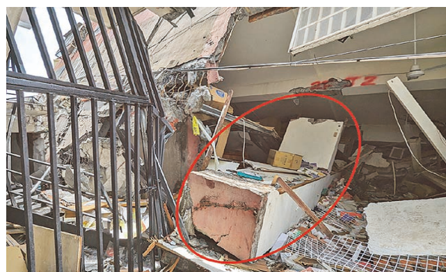
圖 10 天王星大樓夾層與結構體接合不良（北側拍攝）
