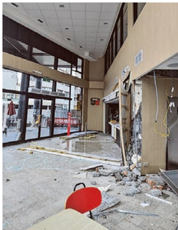
圖 30 吉安麥當勞東南側柱底損壞、主筋挫屈
