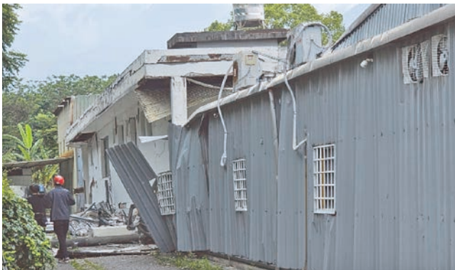
圖 89 0423 吉安鄉自強路廢棄工廠倒塌 (攝影：林家宏)
