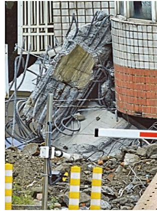
圖 108 0423 統帥花蓮大樓夾層嚴重損害 (攝影：林家宏)
