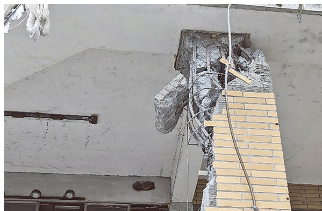
圖 25 北濱街 6 號民宅柱端部受撓剪破壞後，主筋受壓挫屈、箍筋脫開
