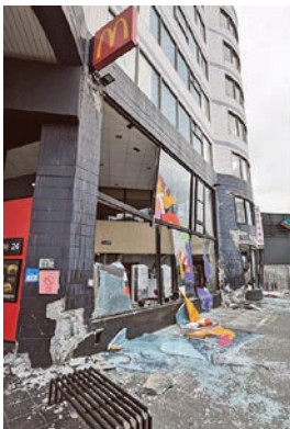
圖 29 吉安麥當勞大樓 損害外觀
