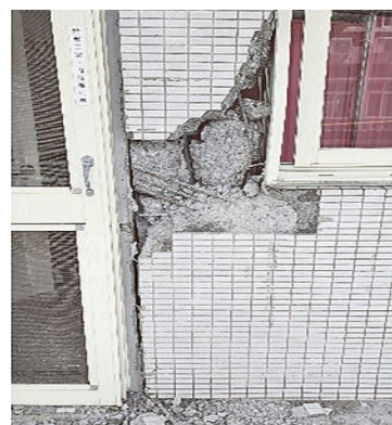
圖 68 花蓮女中窗台牆短柱破壞
