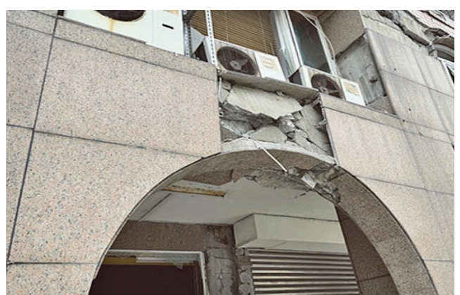
圖 20 統帥花蓮大樓梁斷面最小處剪力破壞
