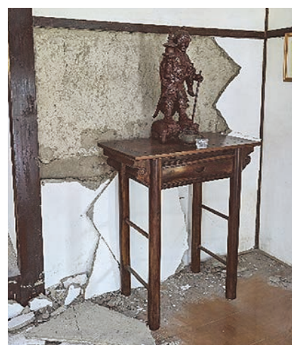
圖 75 慶修院壁體灰泥剝落
