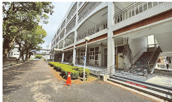
花蓮女中綜合大樓震後南側外觀
