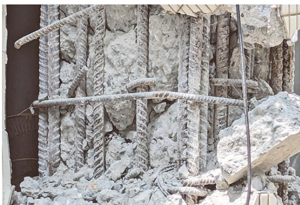
圖 70 花蓮女中柱箍筋脫開、彎鉤角度不足
