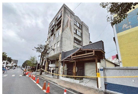
北濱街 6 號民宅震後西南側外觀
