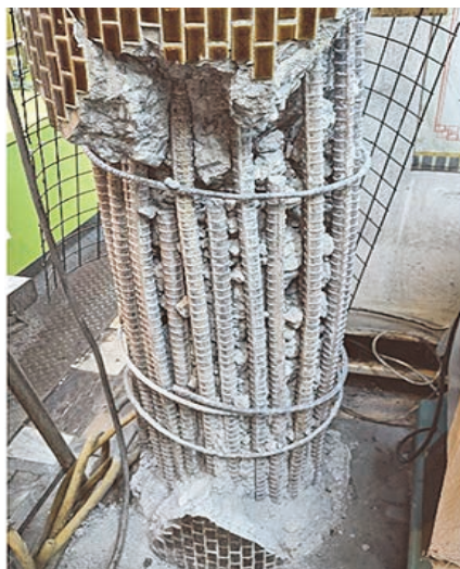
圖 65 鋼管紅茶店柱端部核心混凝土破壞（柱底端部搭接）
