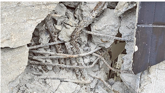
圖 32 吉安麥當勞柱核心混凝土碎裂
