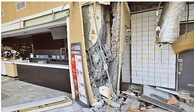
圖 31 吉安麥當勞柱嚴重損害、主筋挫屈
