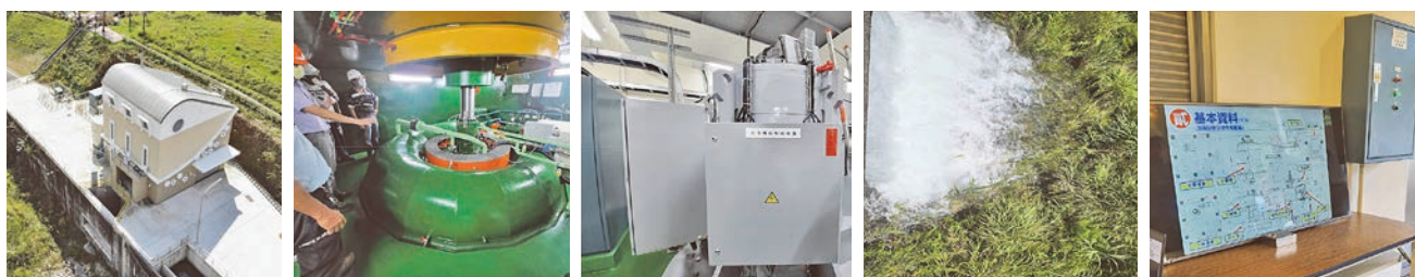
圖 3 景山小水力發電廠現場照片
