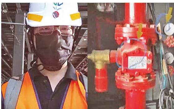
圖 19 MR 設備現場維護檢修狀況 (資料來源: 本研究彙整)
