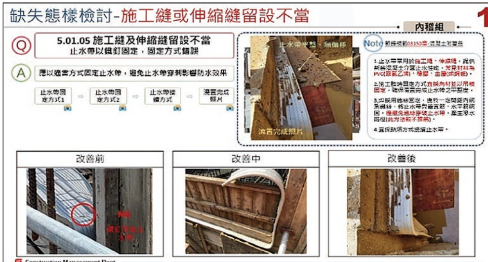
圖 13 查核常見缺失態樣 (混凝土) 檢討
