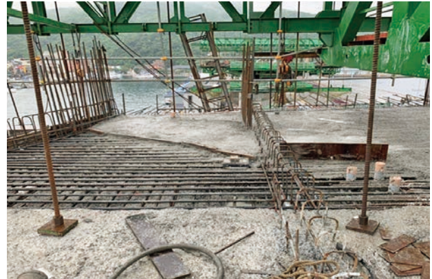
圖 18 工作車下陷後橋面現況
