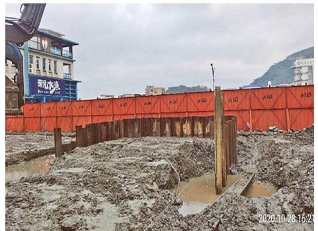
圖 13 鋼板樁打設遭遇地下障礙物
