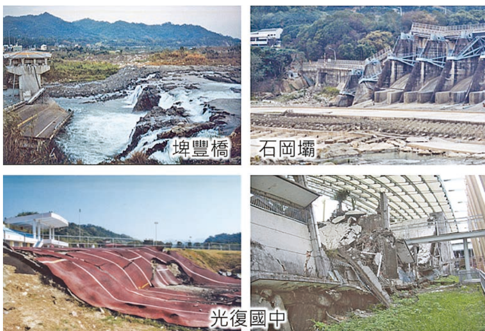
圖 1 集集地震造成之災損 [3]
