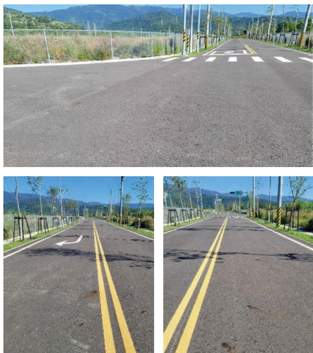
圖 6 使用天然砂石產生之鋪面鏽漬（斑）
