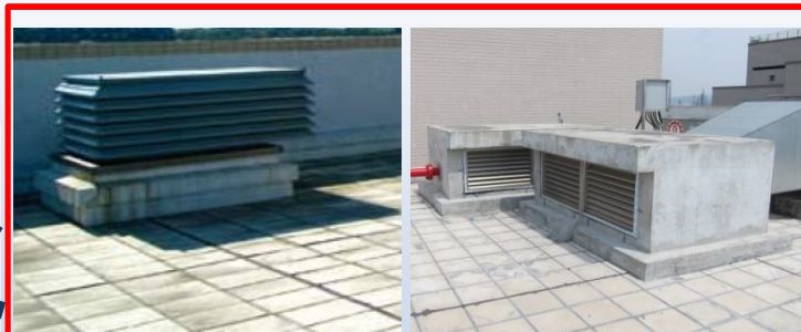
主變壓器室及161kV GIS室屋頂排風機
