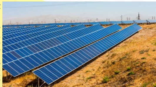
地面型太陽光電站
