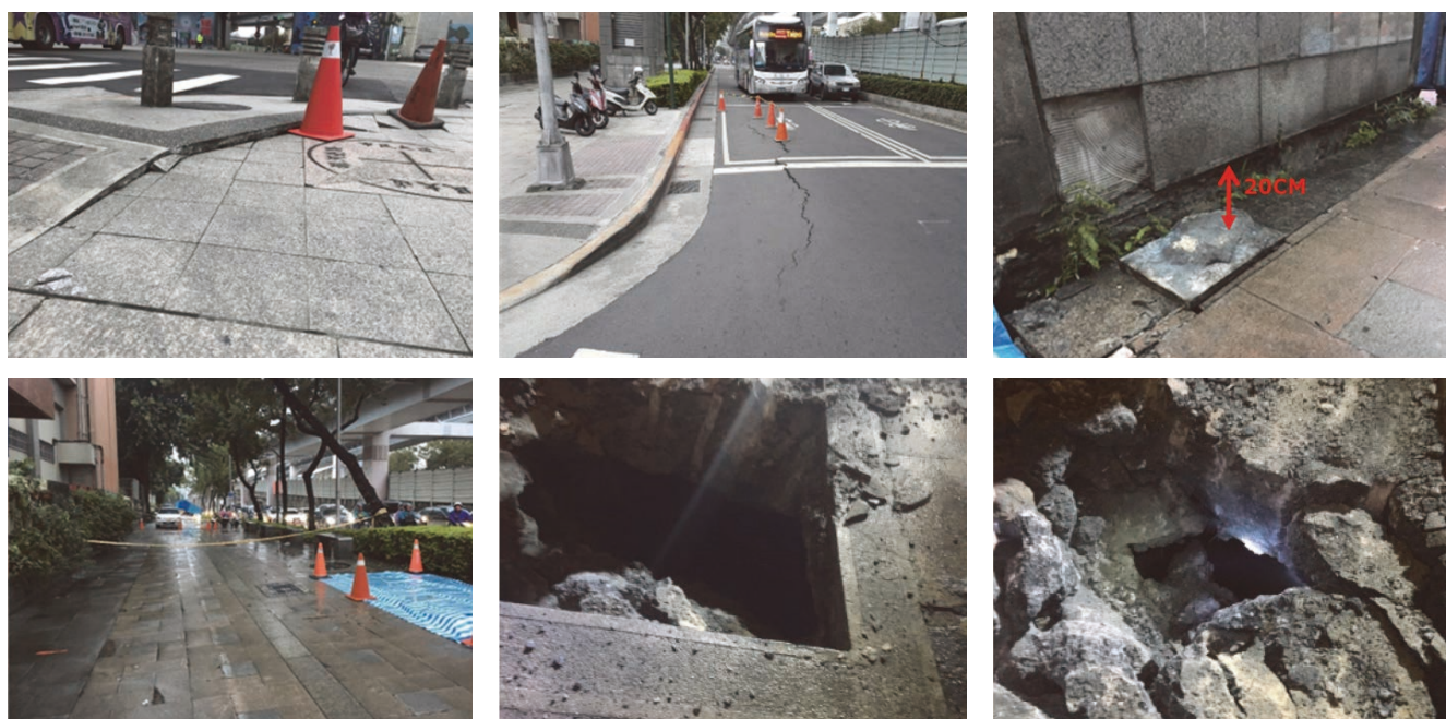
圖 2 人行道掏空及道路下陷情況
