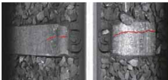
圖 33 軌枕處的裂縫（紅色線處）
