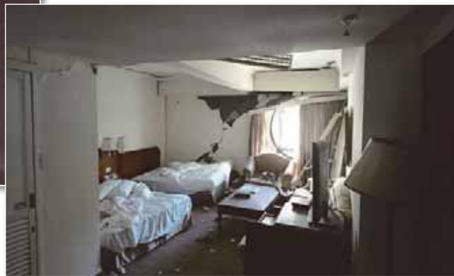
圖 5 倒塌災變現場二
