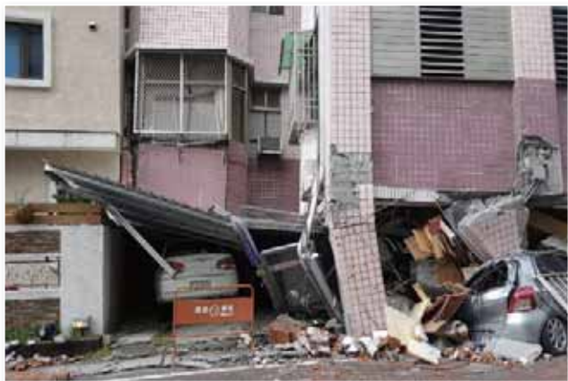
圖 4 弱層建築物一樓崩潰場陷
