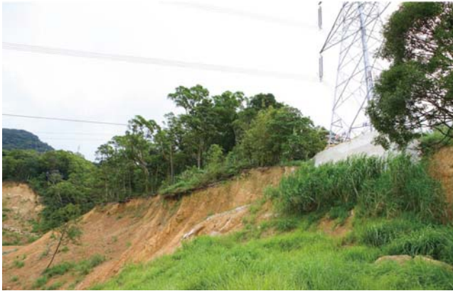
圖 7 台電 345KV 高壓電塔邊坡滑動情形
