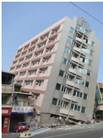
(a) 底層垂直桿件破壞
