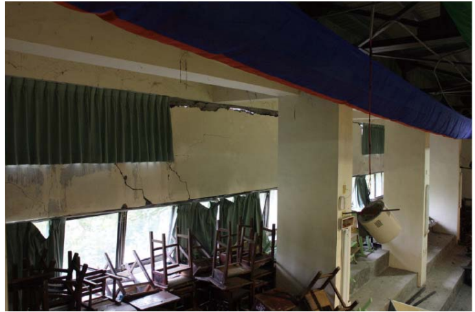
(b) 梁底與下方磚牆交界面開裂
