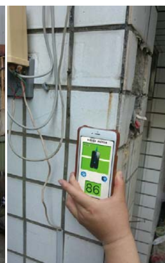
(c) 房屋前傾角度量測
