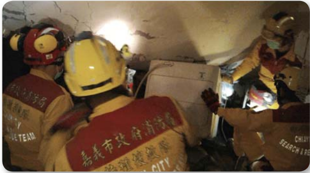
維冠大樓倒塌救災現場內部（土木技師隨同入內拍攝）
