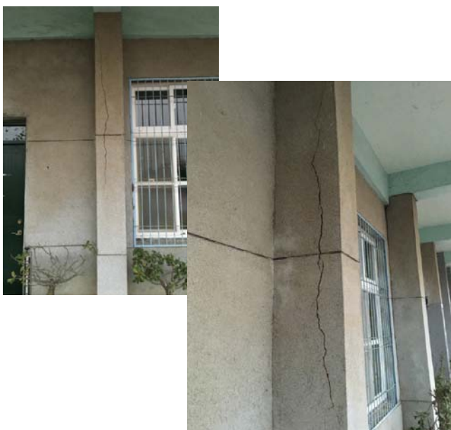
西棟柱體出現垂直裂縫，疑似內部鋼筋鏽蝕膨脹，地震作用後裂縫加大
