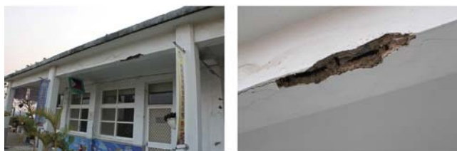
(b) 西棟走廊側梁底混凝土剝落，可見梁內鋼筋已生鏽（研判非本次地震造成）
