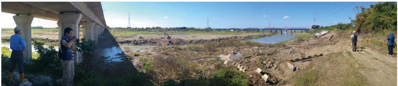
圖 24 南二高曾文溪橋堤岸側潰破壞情況 (許尚逸提供)
