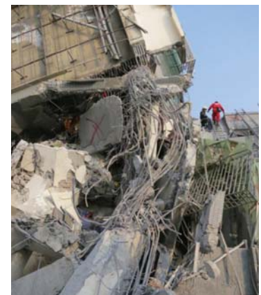
(b) 柱箍筋量不足
