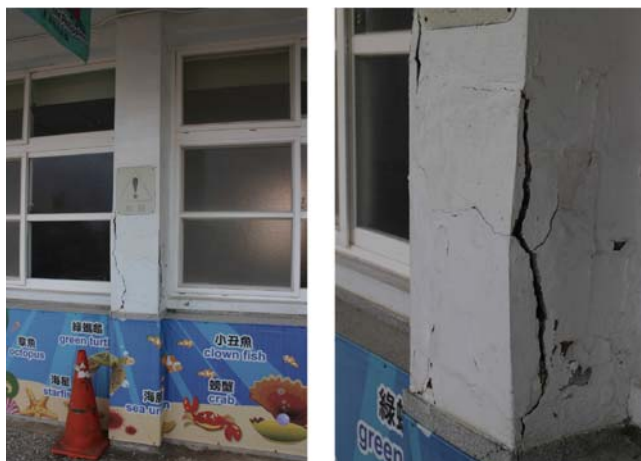
(a) 西棟柱體出現垂直向裂縫，疑似內部鋼筋鏽蝕膨脹，本次地震後出現開裂
