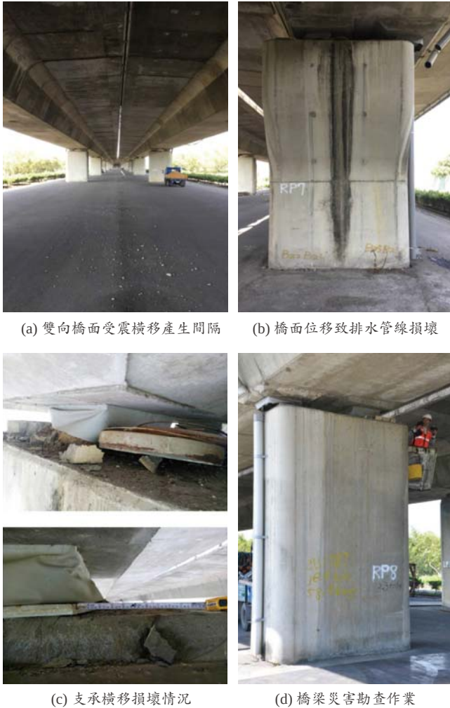
圖 19 台 86 線 24 號橋橋梁災害調查 (劉光晏及許家銓提供)
