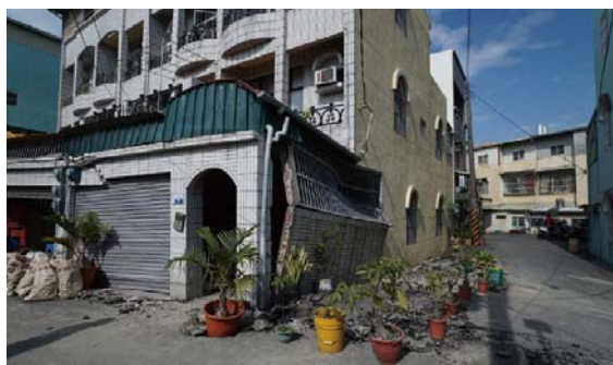
(a) 建物傾斜下陷
