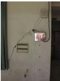
(c) 牆面出現斜向裂縫，另一面亦出現裂縫
