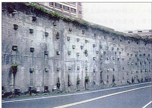
圖 11 台北市萬芳路地錨錨頭凌亂且出水
