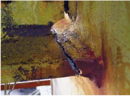
圖 3 梁翼板在腹板銲接扇形開孔尖端附近發生斷裂破壞 [8]
