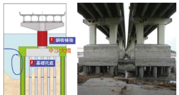
圖 5 基礎增樁使沖刷加劇
