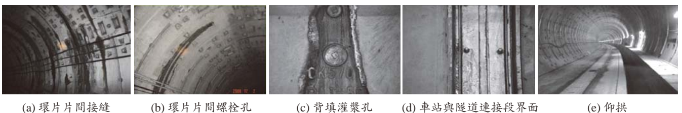
圖 2 台北捷運隧道常見滲漏異狀
