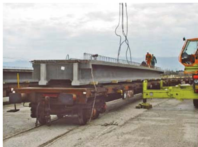
圖 12 法國 Bourg-lès-Valence 橋梁採用之超高性能纖維混凝土橋面版
