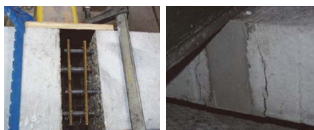
(a) 兩預鑄梁間之填充縫 (AARUP) (b) 彎曲測試破壞圖 (AARUP) 圖 22 預鑄構件之超高性能纖維混凝土填充縫
