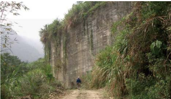
圖 4 擋土牆高度太高水平抵抗不足而位移
