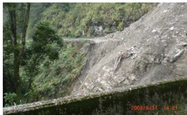
圖 5 邊坡滑動道路路基流失
