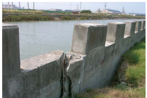
圖 2 河岸設施因被動不足而位移
