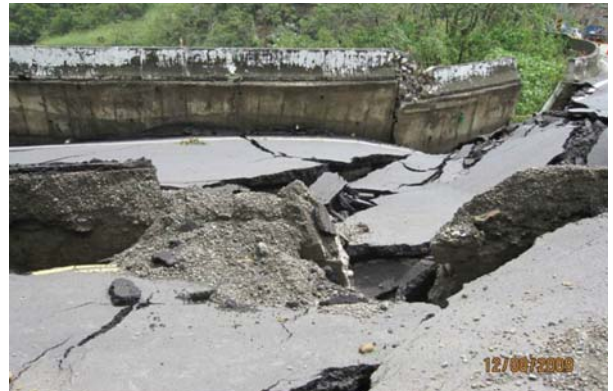
圖 1 道路位於滑動區而破壞
