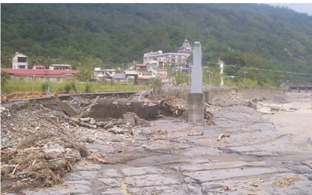
圖 10 護岸基礎掏刷而破壞
