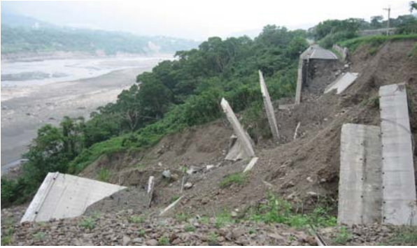
圖 3 擋土牆因邊坡坡趾掏刷而破壞
