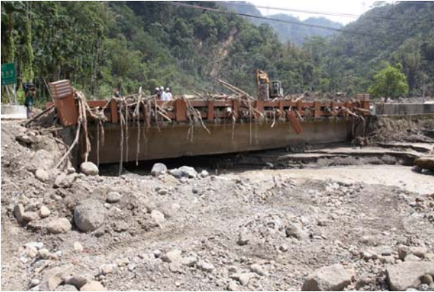
圖 6 橋梁跨度與淨高不足
