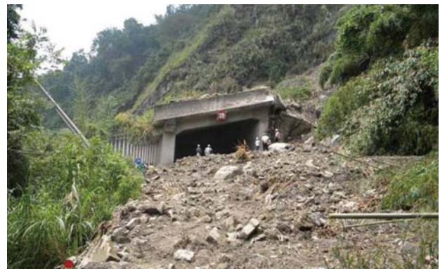
圖 12 明隧道長度不足洞口遭土石掩埋
