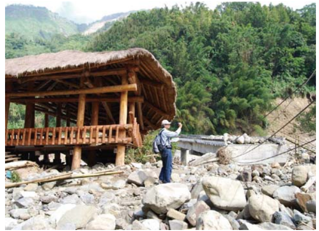
圖 8 橋梁遭洪水、土石流沖毀
