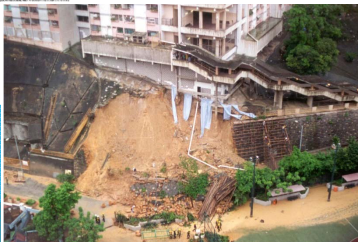
1994觀龍樓擋土牆崩塌– 5人死亡
